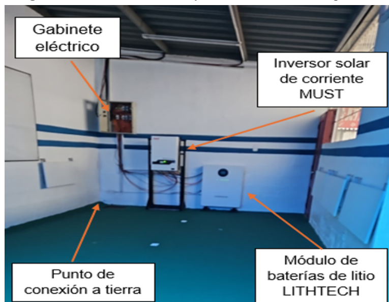
Figura 2. Inversor solar híbrido y módulo de baterías en operación.
