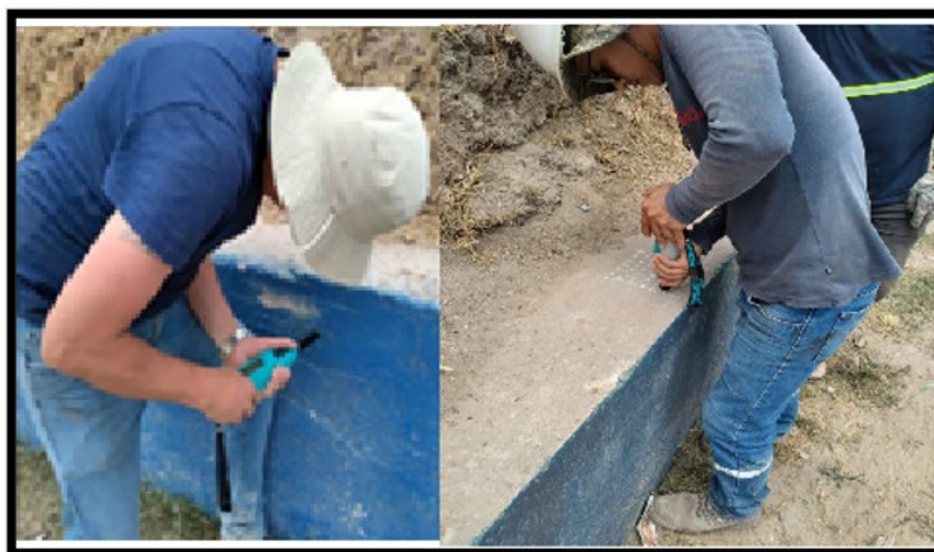
Figura 3. Condiciones de la superficie del muro
