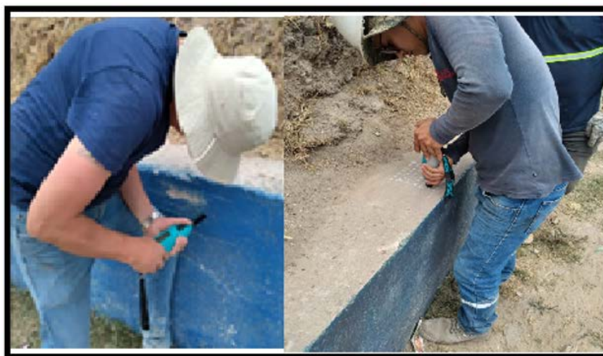
Figura 3. Condiciones de la superficie del muro
